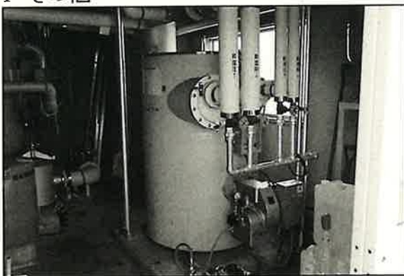
現在のボイラー
