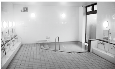
人気のお風呂の配管設備は限界
