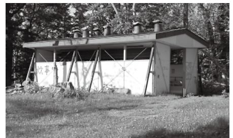
トイレはバイオトイレ・大人数の対応には処理能力は追いつかない炊事場も老朽化が進んでいます
